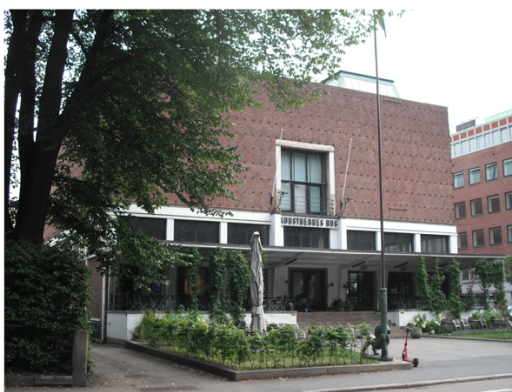
Den populære bygningen har stort vedlikeholdssjesslep og er i svært dårlig forfatning. Foto: Torgeir Holten Thon
